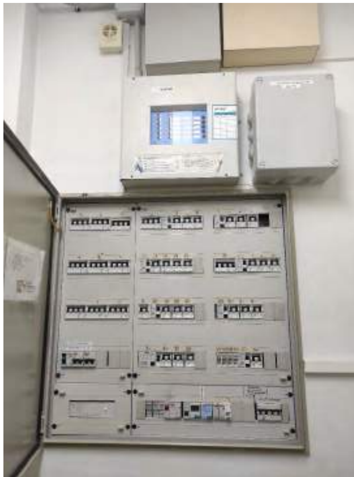
Cuadro existente para Interconexión
