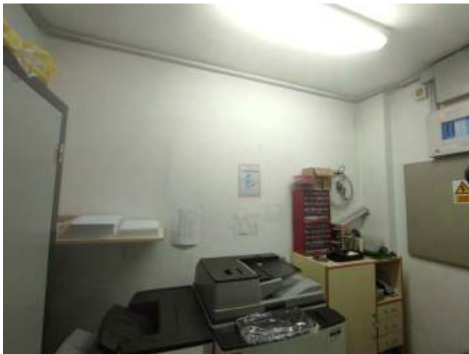
Espacio para ubicar inversores y cuadro protecciones
