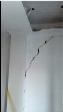
2.- GRIETA EN TABIQUE
