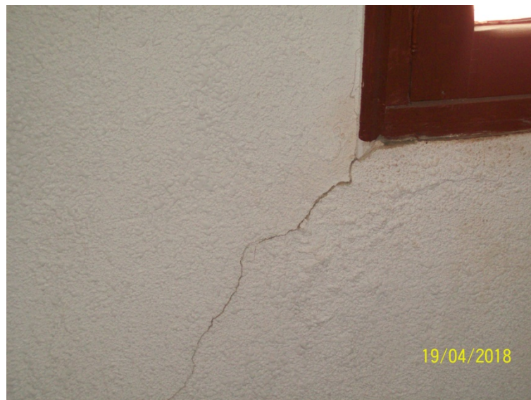
Fisura en cerramiento de fachada
