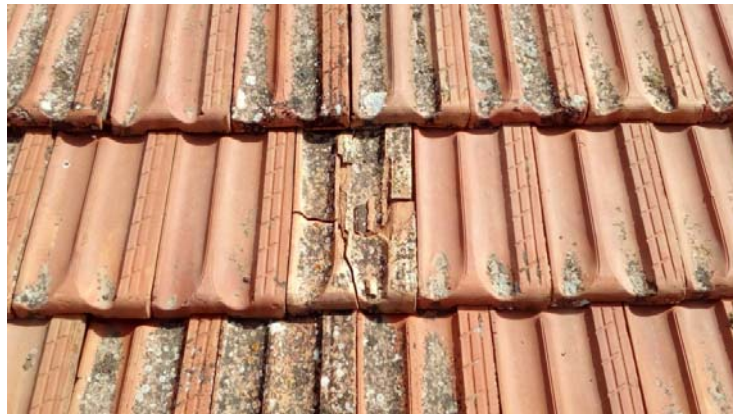
Cubierta inclinada con la teja rota.
