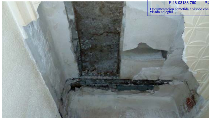
Vigueta con aluminosis, y fisurada. Escayola rota.
