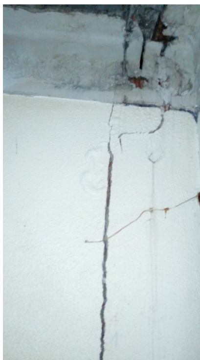
Grieta en tabique que se prolonga hasta el techo.
