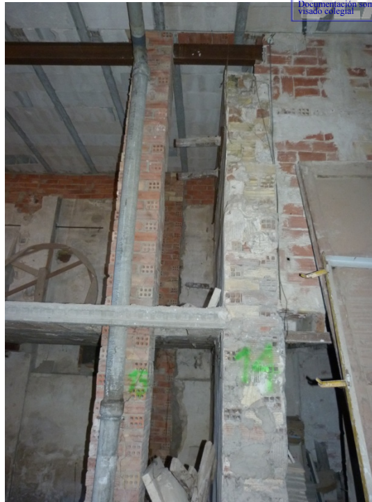
Derivación y bajante de fibrocemento. Se observan las fugas
