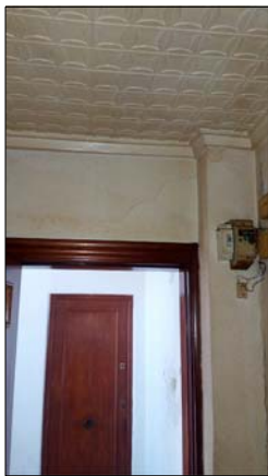
1.- FISURA DINTEL PUERTA GRIETA ENCUENTRO CON PILAR
