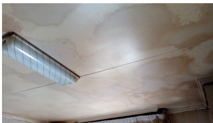
Techo de escayola con humedades y fisura de marcado de vigueta.
