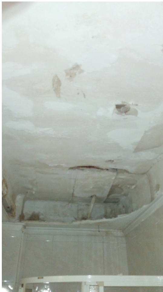
Humedades en techo, grieta y vigüeta fisurada, con pérdida de sección y aluminosis.
