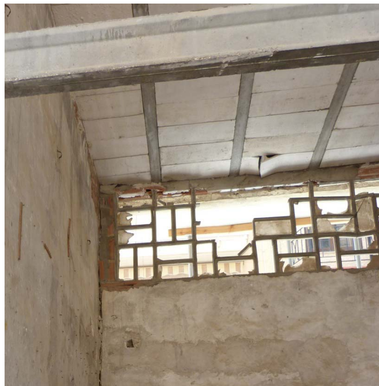
Celosía y cargadero rotos.
