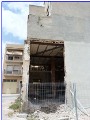
13.- CERRAMIENTO DE MEDIANERA SIN TERMINAR
