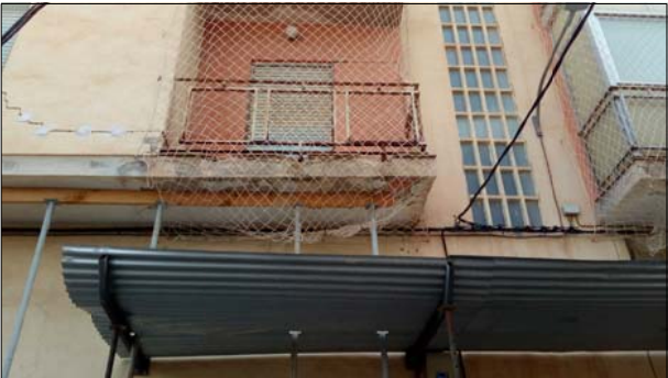
5.- FORJADO FLECHADO APUNTALAMIENTO HUMEDADES CANTO DE FORJADO
