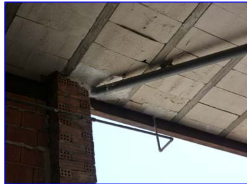
4.- 2 VIGUETAS CON ALUMINOSIS, CLORUROS CON PERDIDA SECCIÓN HORMIGÓN Y ARMADURA
