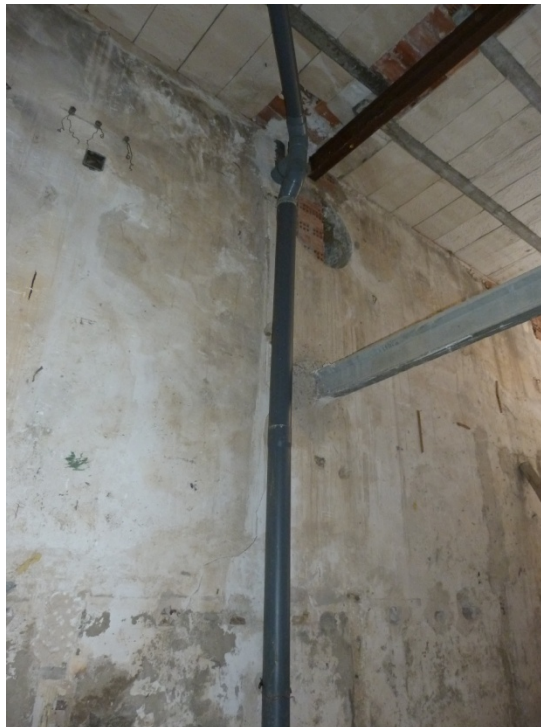
Derivación y bajante de PVC
