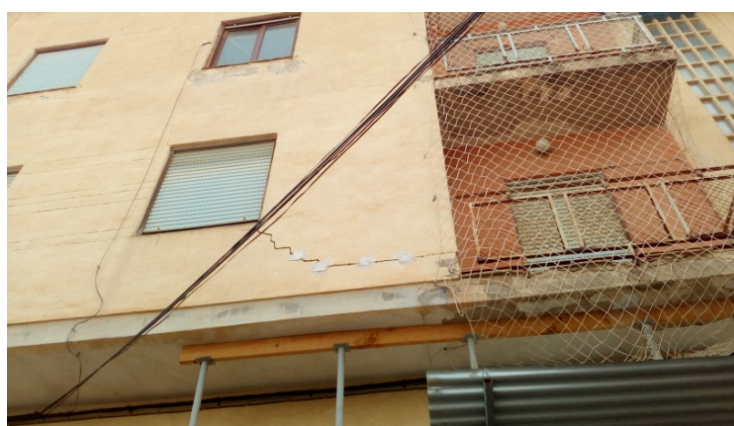
Grieta en cerramiento de fachada por el exterior, canto de forjado con humedades
