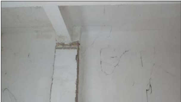
6.- FISURA EN TECHO
