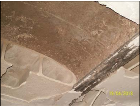
10- VIGUETAS CARBONATADAS ALUMINOSIS HUMEDADES
