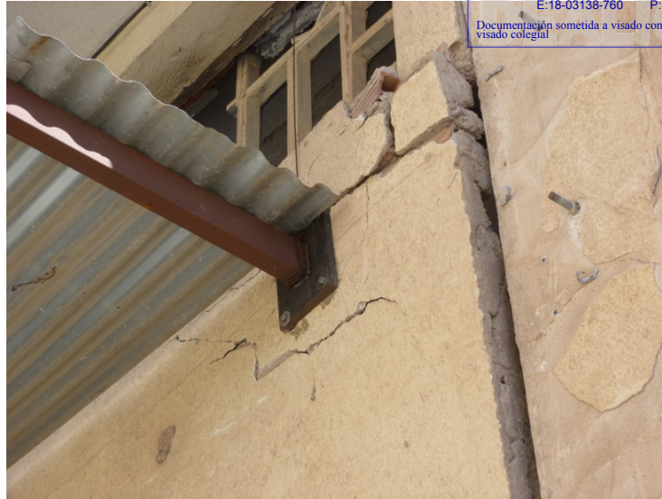
Desplome del muro de fachada
