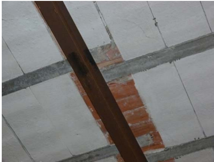
Oxidación en viga
