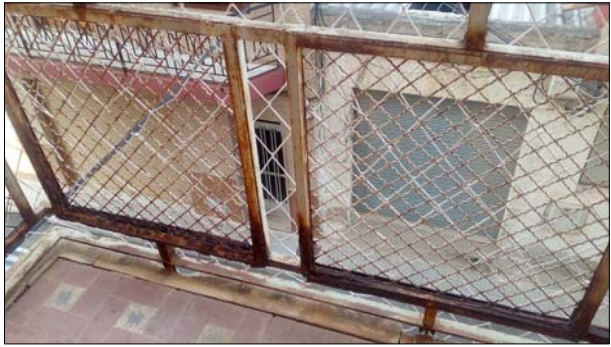
2.- ROTURA PAVIMENTO OXIDACIÓN BARANDILLA
