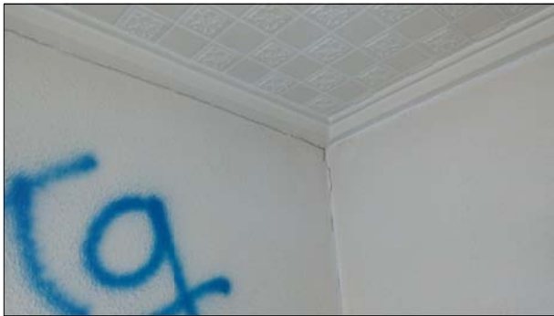
3.- FISURA EN TABIQUE Y MOLDURA ESCAYOLA
