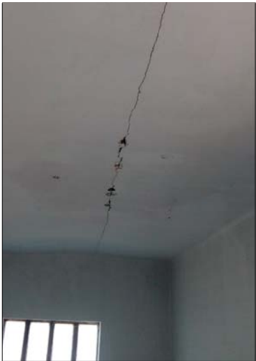
3.- GRIETA Y HUMEDADES EN TECHO CASETÓN DE ESCALERA
