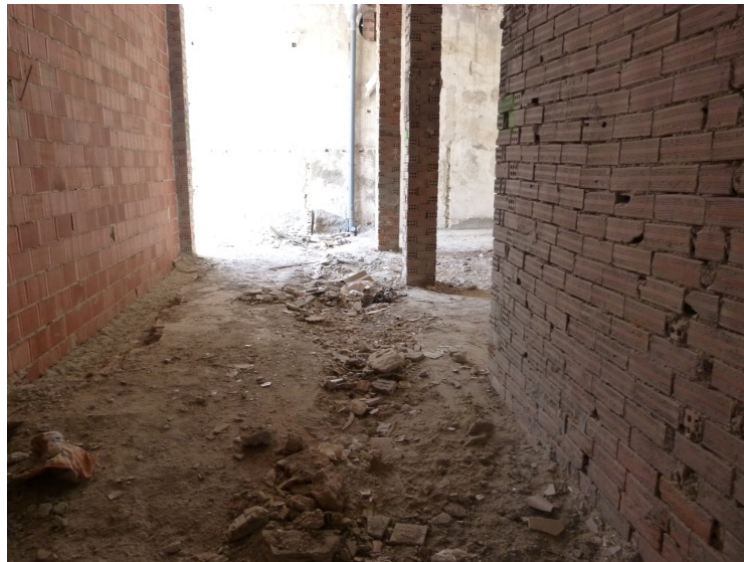
Marcado del saneamiento horizontal con fugas.
