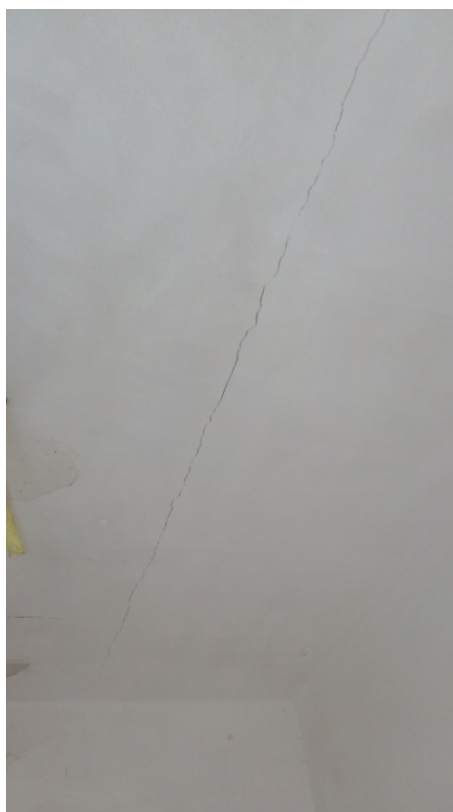
Fisura en techo
