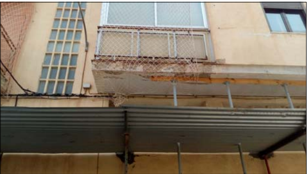
11.- FORJADO FLECHADO APUNTAMIENTO HUMEDADES CANTO DE FORJADO OXIDACIÓN BARANDILLA
