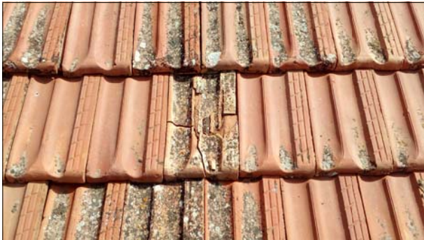
1.- TEJA ROTA EN CUBIERTA (4 UDS)
