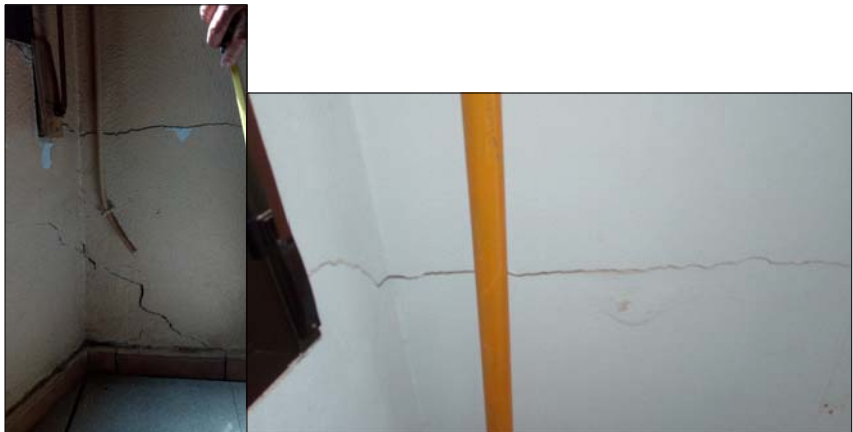
9.- GRIETA EN CERRAMIENTO DE FACHADA HUMEDADES
