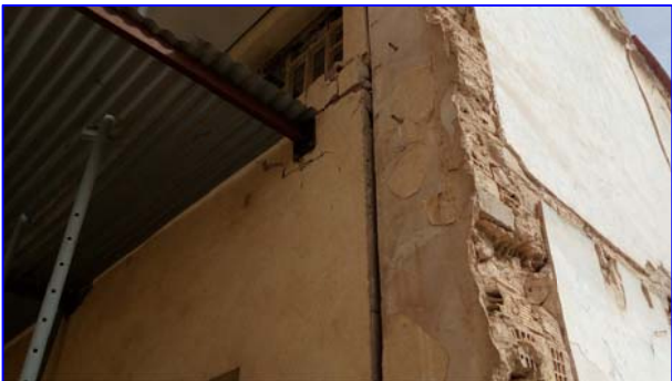
8.- DESPLOME Y GRIETA EN MURO DE FACHADA
