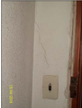
2.- FISURA EN TABIQUE
