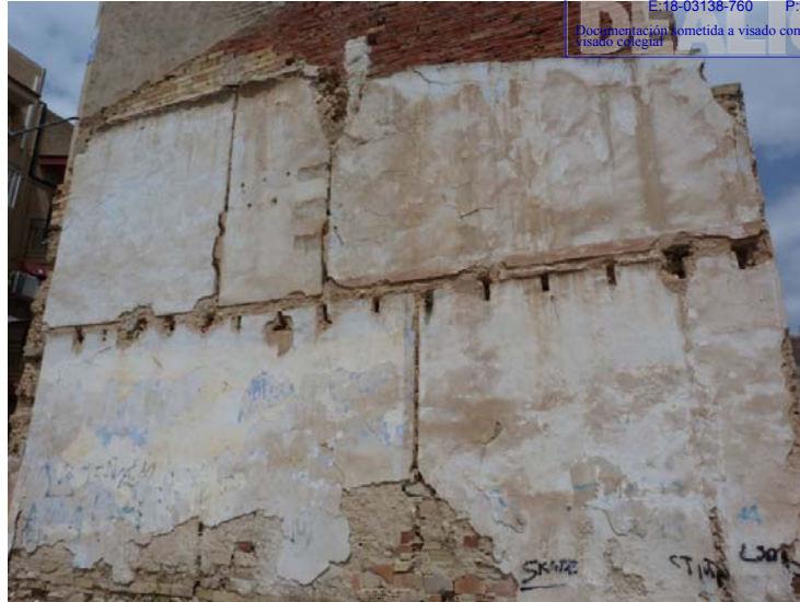
Muro medianero con desconchados y fisuras
