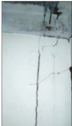
11.- GRIETA ENCUENTRO TABIQUE-PILAR
