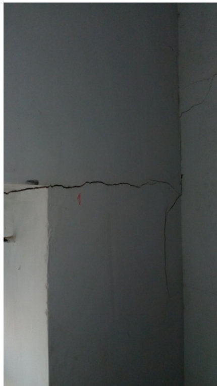
Grietas en cerramiento caja escalera
