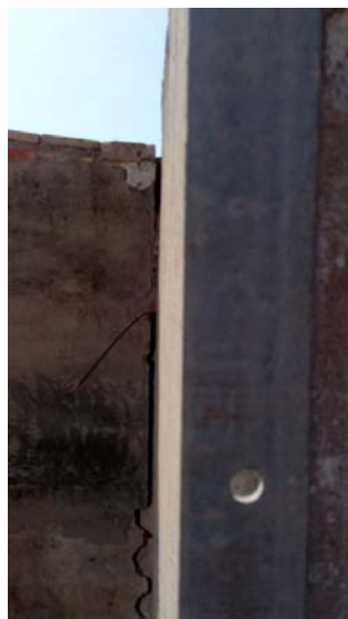
Cerramiento de trastero, desplome y grieta.
