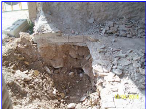
14.- SOCAVÓN EN TERRENO
