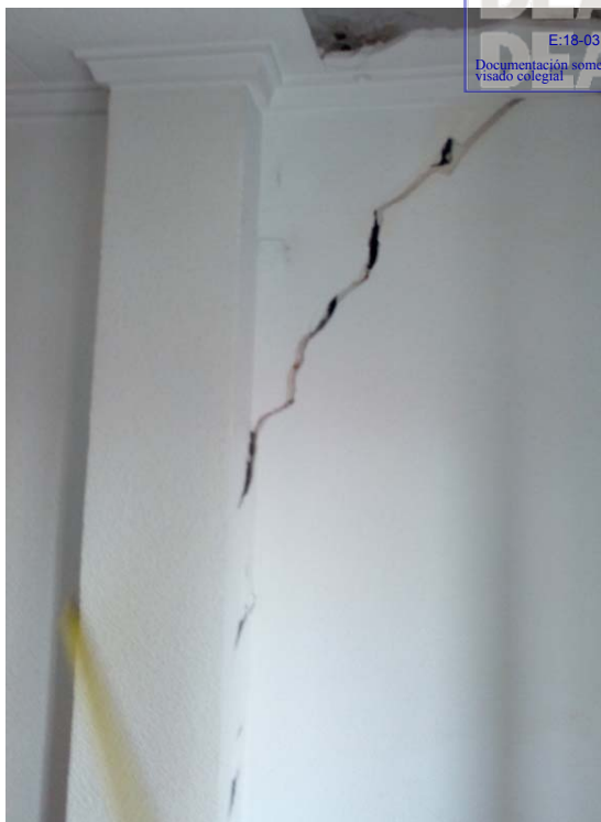
Grieta en tabiquería
