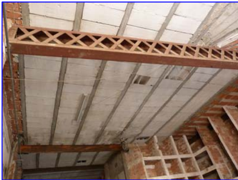
1.- 5 VIGUETAS CON ALUMINOSIS, CLORUROS CON PERDIDA SECCIÓN HORMIGÓN Y ARMADURA
