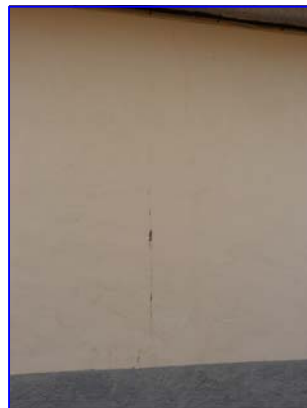
10.- FISURA EN CERRAMIENTO FACHADA
