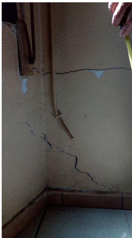
Grietas y humedades en el cerramiento de fachada.
