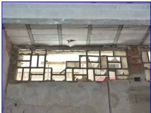
9.- ROTURA DINTEL APOYO VIGUETAS
