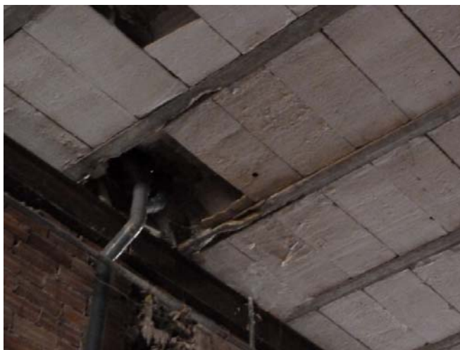
Viguetas con pérdida de sección, rotura de bovedillas
