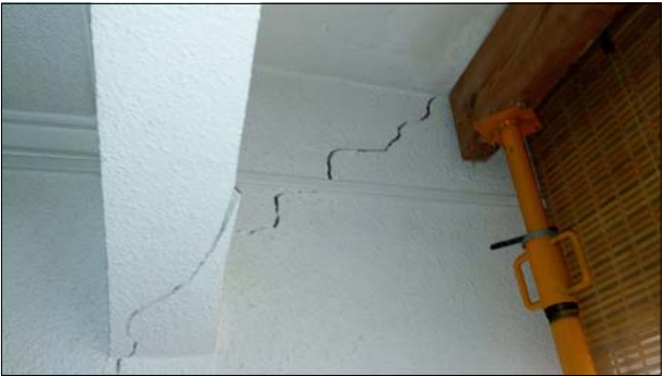
1.- GRIETA EN TABIQUE APUNTAMIENTO INTERIOR
