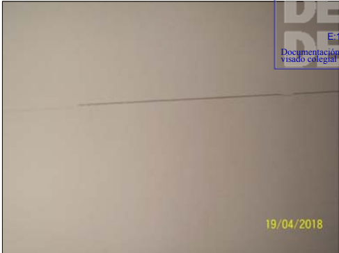
6.- FISURA EN TECHO DE ESCAYOLA
