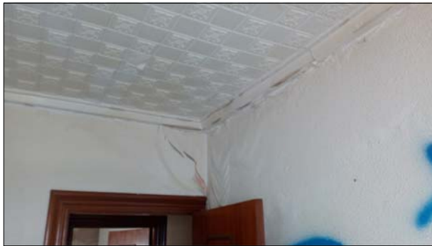
2.- HUMEDADES TECHO, TABIQUE Y DINTEL PUERTA
