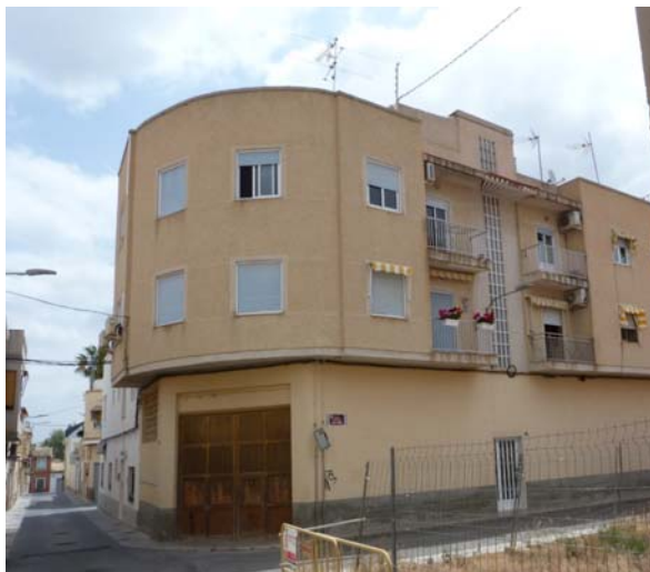
Estado de la fachada del nº 1
