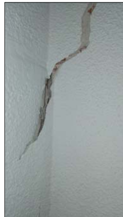
7.- GRIETA ENCUENTRO PILAR-TABIQUE
