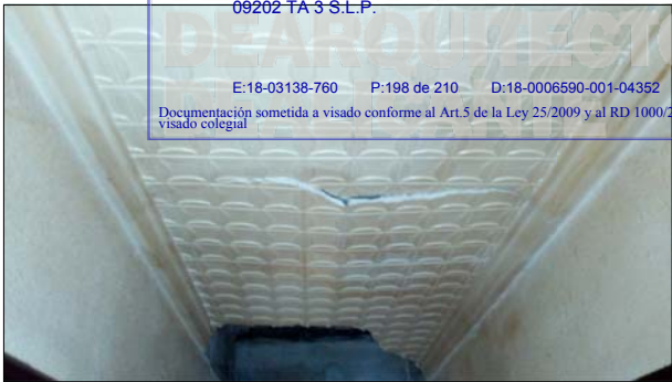
6.- GRIETA EN TECHO DE ESCAYOLA
