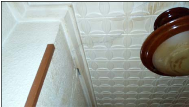
5.- FISURA EN ESCAYOLA FISURA EN ENCUENTRO CON PILAR
