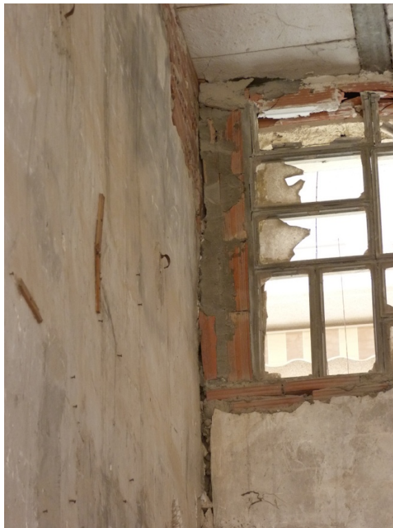
Desplome del muro medianero
