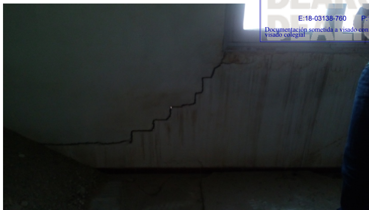
Grieta en cerramiento de fachada por el interior
