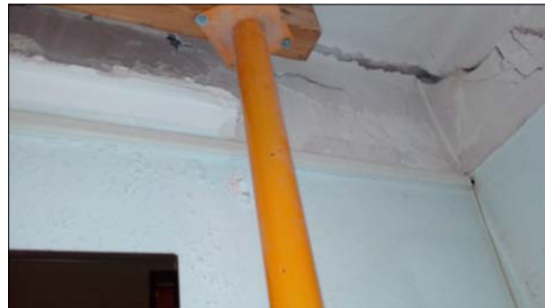
8.- GRIETA EN TABIQUE Y TECHO APUNTALAMIENTO FORJADO
