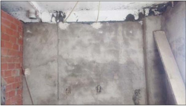
1.- HUMEDADES EN CERRAMIENTOS
