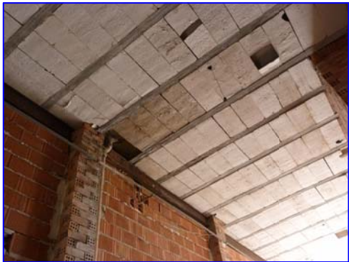
3.- 3 VIGUETAS CON ALUMINOSIS, CLORUROS CON PERDIDA SECCIÓN HORMIGÓN Y ARMADURA
