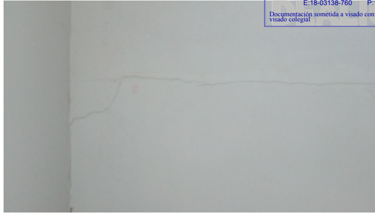
Fisura en cerramiento interior caja escalera.
