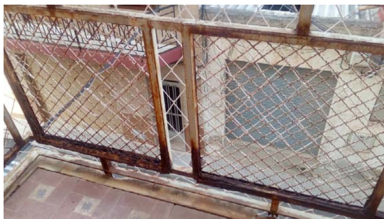
Barandilla oxidada, pavimento roto.
