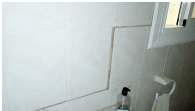
La misma grieta por el interior en cuarto de baño.
