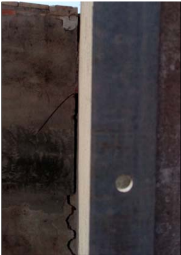
3.- GRIETA Y DESPLOME DEL CERRAMIENTO DEL PATIO (TRASTERO)
