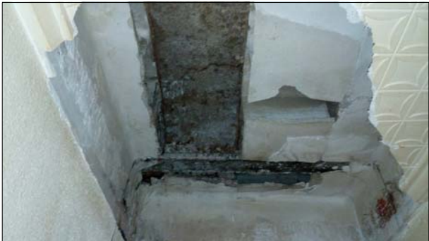
13.- VIGUETA FISURADA CON ALUMINOSIS
