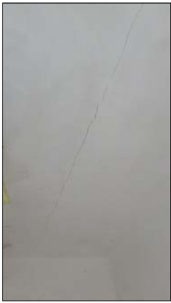
3.- FISURA TECHO ESCAYOLA
