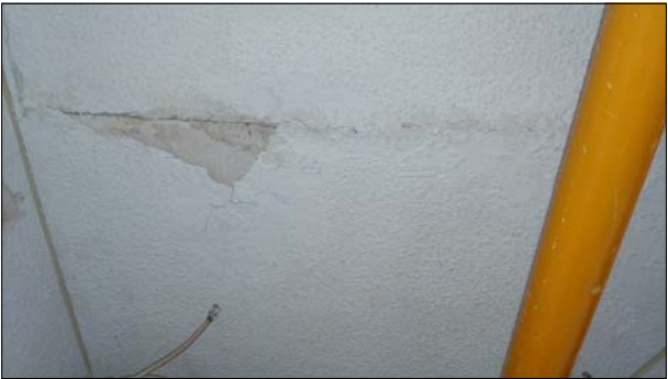
3.- FISURA HORIZONTAL EN CERRAMIENTO FACHADA
