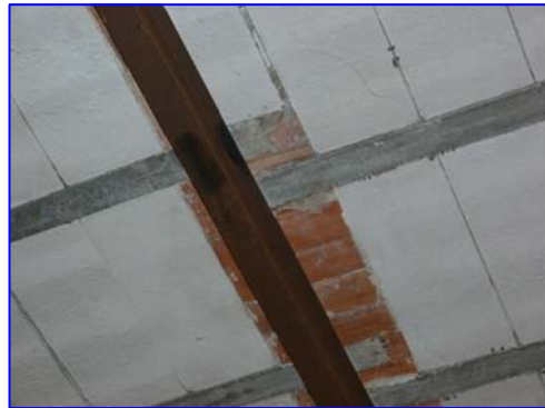
6.- OXIDACIÓN DE LAS VIGAS METÁLICAS
