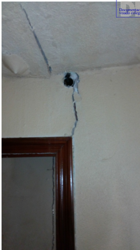
Grieta en tabique desde el dintel hasta la caja de electricidad.
