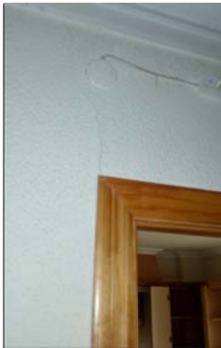
7.- FISURA EN TABIQUE
