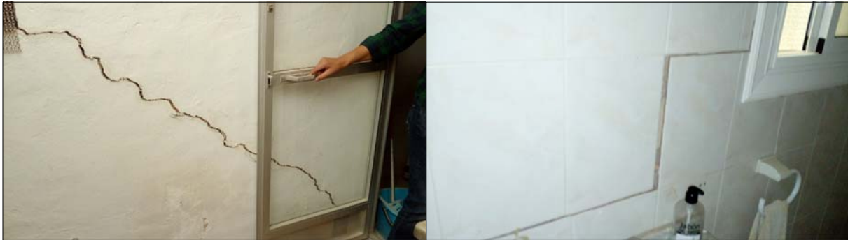
6.- GRIETA EN CERRAMIENTO BAÑO-PATIO
