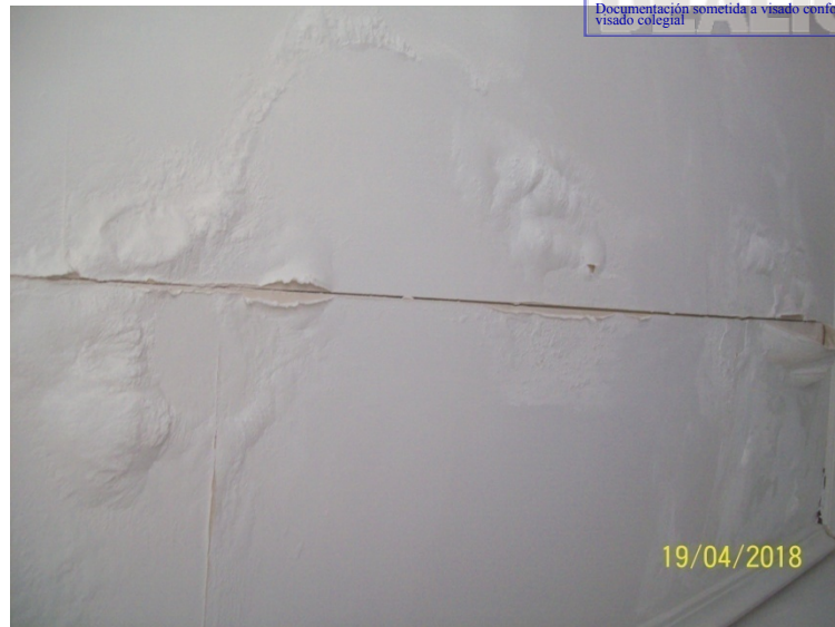
Fisura y humedades en techo de escayola.
