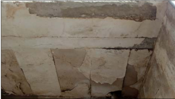
7.- VIGUETA FISURADA EN TECHO HUMEDADES BOVEDILLAS ROTAS
