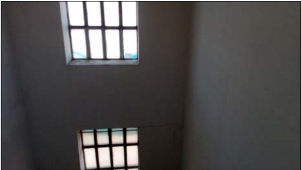
4.- GRIETA EN CERRAMIENTO CASTENÓN DE ESCALERA
