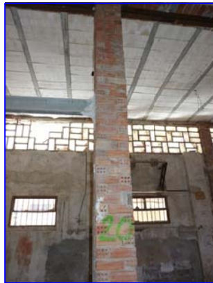
5.- DESPLOME DE PILARES
