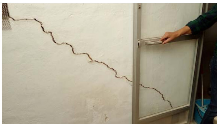
Grieta en cerramiento de patio.
