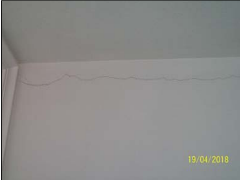
3.- FISURA EN TABIQUE
