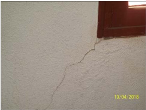
9- FISURA EN CERRAMIENTO DE FACHADA
