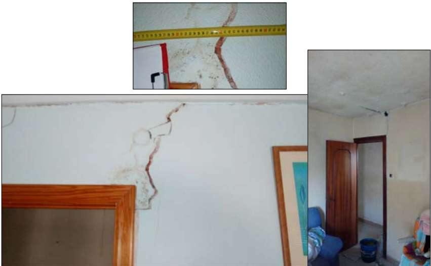
10.- GRIETA EN TABIQUE Y TECHO HUMEDADES
