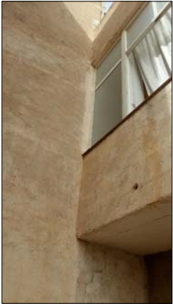
8.- FISURA EN CERRAMIENTO PATIO-ESCALERA
