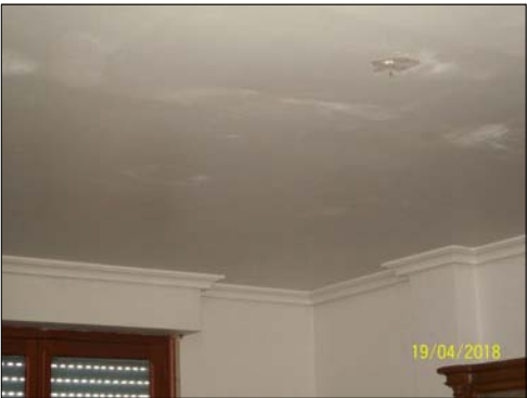
7.- HUMEDADES EN TECHO
