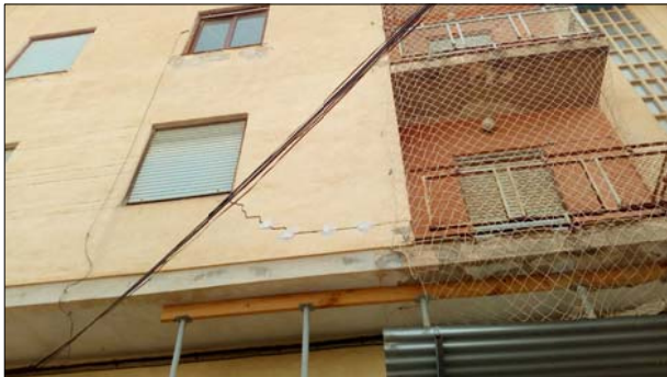
4.- FISURA, HUMEDADES EN TABIQUE
