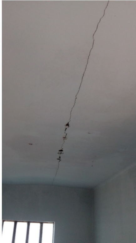
Grieta y humedades en techo caja escalera
