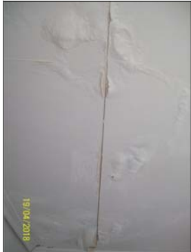
1.- FISURA TECHO ESCAYOLA HUMEDADES
