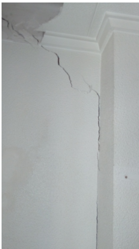
Grieta de tabique hasta techo.
