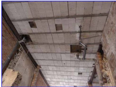
2.- 3 VIGUETAS CON ALUMINOSIS, CLORUROS CON PERDIDA SECCIÓN HORMIGÓN Y ARMADURA
