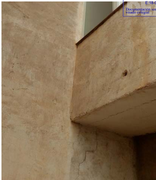
Fisura en antepecho, techo galería y cerramiento patio.
