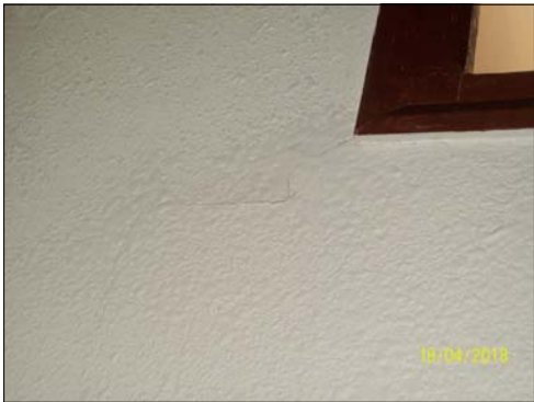
8- FISURA EN CERRAMIENTO DE FACHADA
