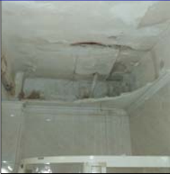
5.- GRIETA EN TECHO VIGUETA CON FALTA DE SECCIÓN HUMEDADES
