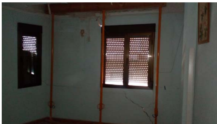
Agrietamiento de fachada.
