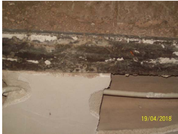
Viguetas con aluminosis, y fisurada.
