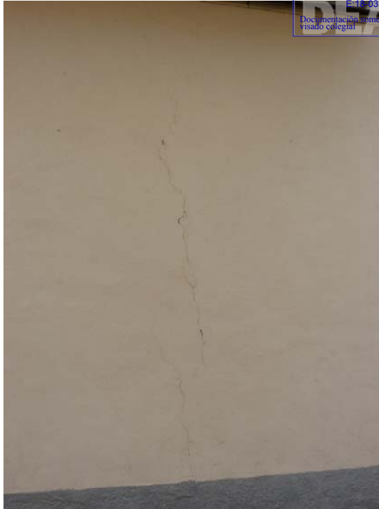
Fisura en el cerramiento de planta baja en el nº 1
