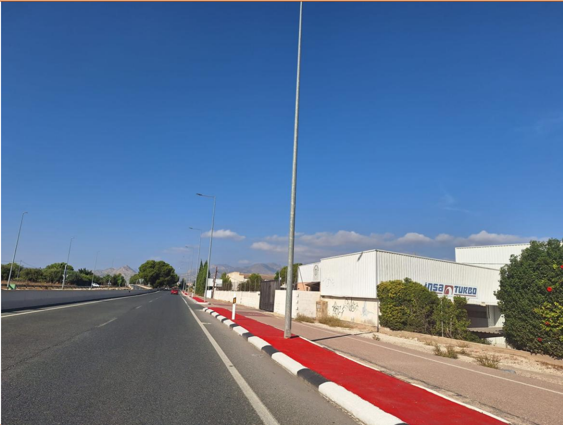
Imagen de la N-325 hacia TM de Novelda, en el muro de separación de los carriles, se acumula la acícula de los pinos e impide el paso del agua provocando una acumulación de la misma.
