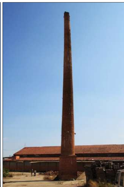
Fig nº 31 Desplome desde el Oeste.
