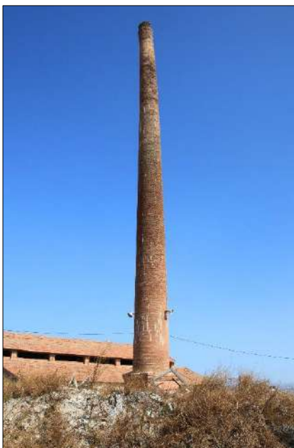
Fig nº 30 Desplome desde el Sur Oeste.
