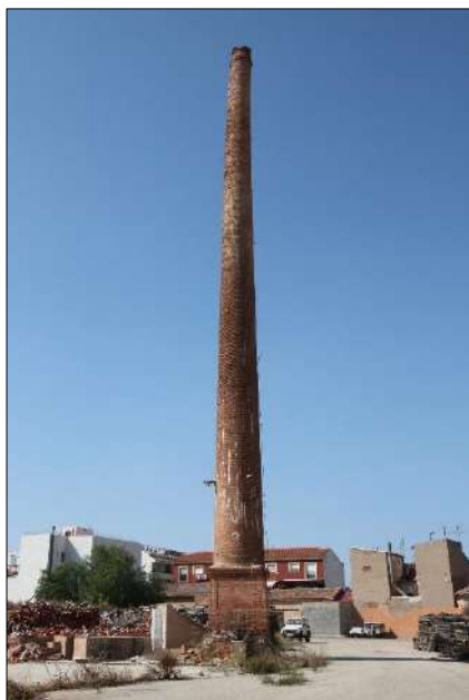
Fig nº 29 Desplome desde el Este.
