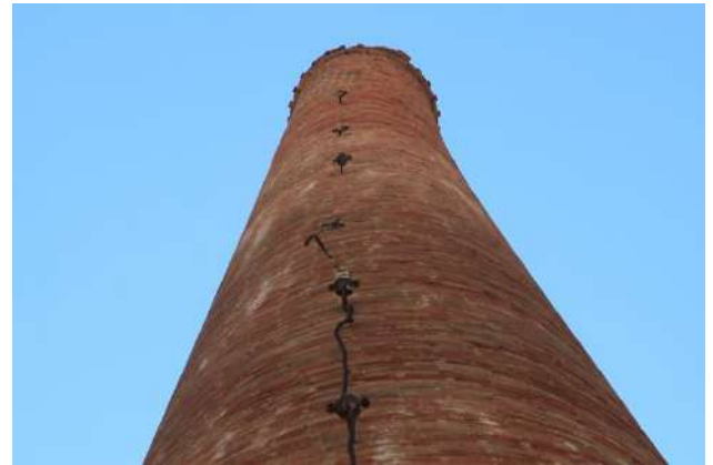
Fig nº 39 Traza de aisladores y cable de puesta a tierra.
