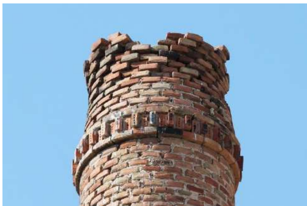
Fig nº 36 Desmoronamiento en corona.
